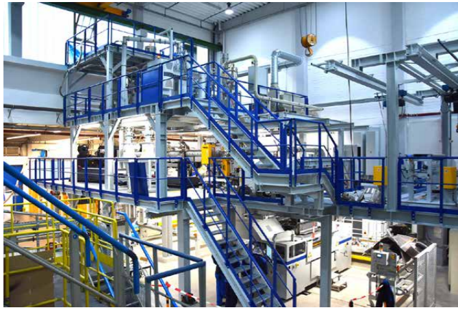
Vollgepackt mit hochmoderner Technologie - unsere neue PET-Extrusionsanlage der Firma Reifenhäuser®
